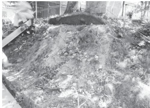
21-2 体育館東側コンクリート・石垣 撤去後の状況 (南西より)
