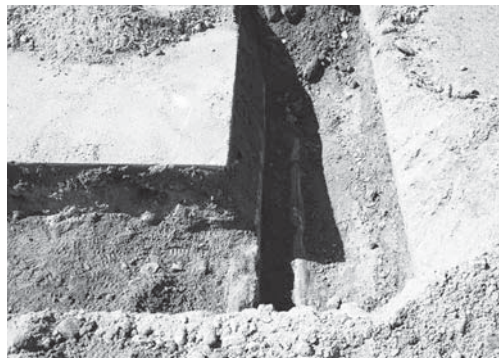
20-6 屋外排水管敷設箇所北側東端部分の 北側コンクリート面検出状況（東より）
