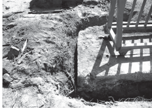
22-2 体育館東側コンクリート・石垣 撤去後の状況（南西より）
