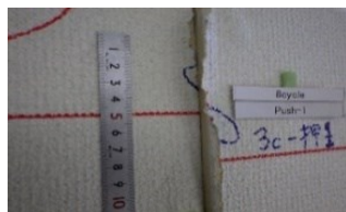
写真 2.4 石膏ボードの浮き
