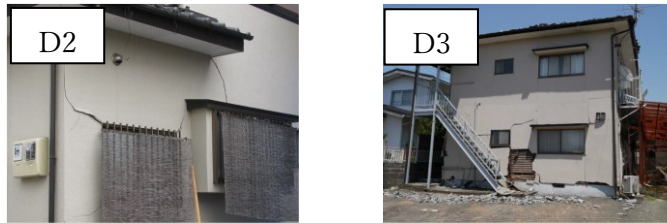
写真 2.11 モルタル外壁仕上げの損傷状況の例
