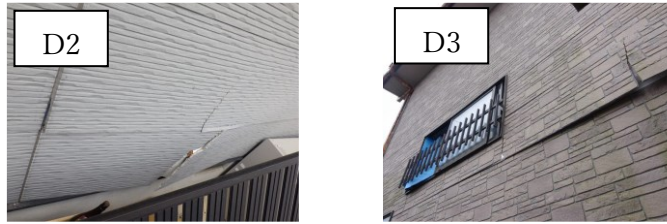
写真 2.10 サイディング仕上げ外壁の損傷状況の例
