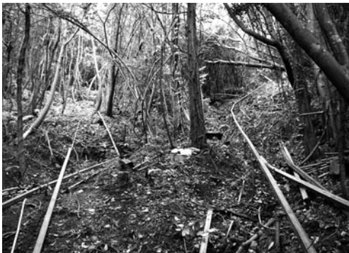
7-5 モノレール敷設作業状況 (写真右側が新規敷設路線) (南より)
