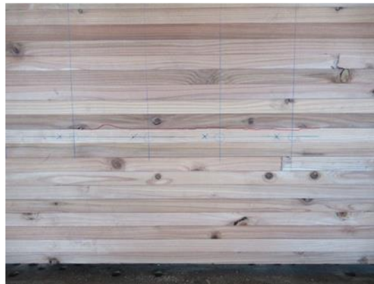
柱材せん断割れ
