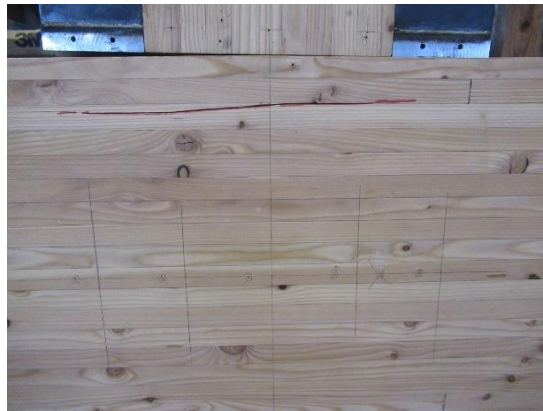
柱材側せん断金物ビス底部付近の横引張割れ
