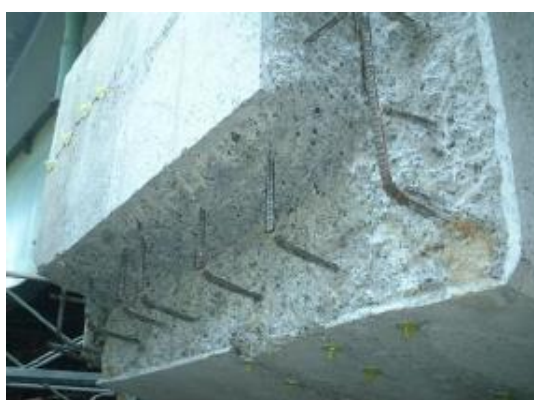
図 1-4 ASR による鉄筋破断 5)
