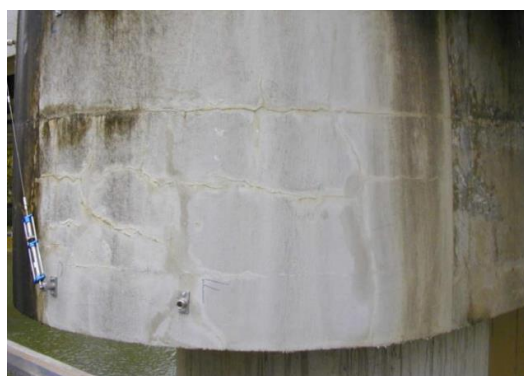
図 1-17 DEF の無拘束状態のひび割れ 16)
