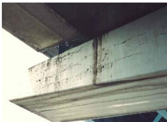
図 1-2 拘束状態のひび割れ 4)
