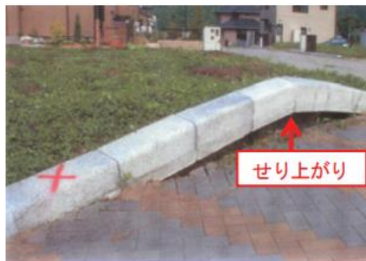
図 1-18 異常膨張によるせり上がり 17)
