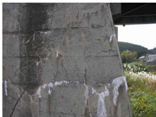
図 1-3 ひび割れからのゲルの滲出 4)
