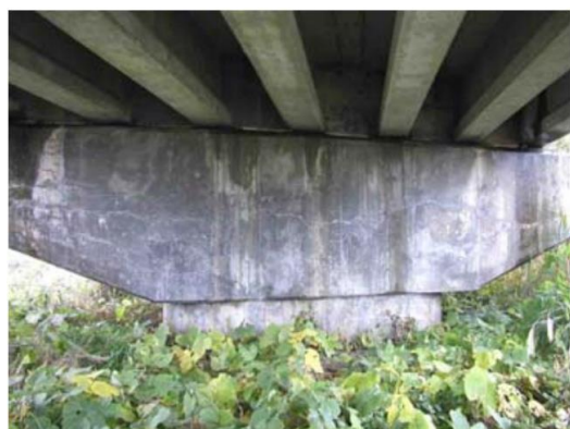
図 1-1 無拘束状態のひび割れ 4)
