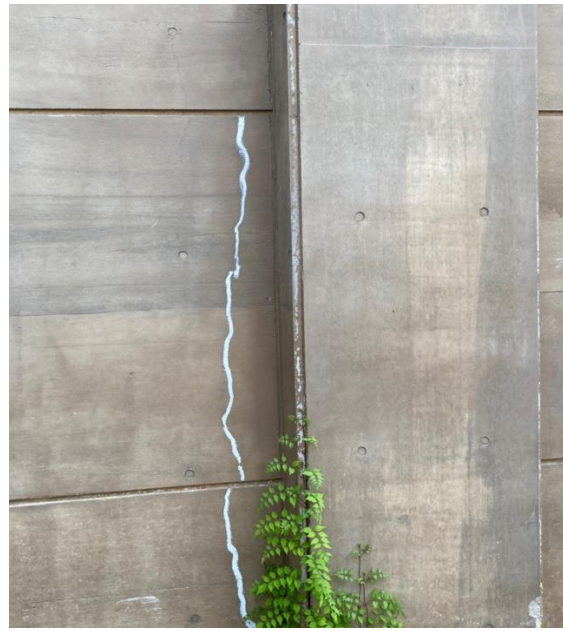
端部ひび割れ（屋外側）
