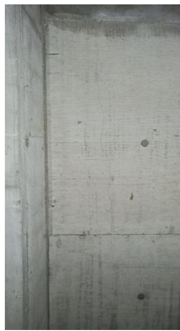
端部ひび割れ（屋内側）
