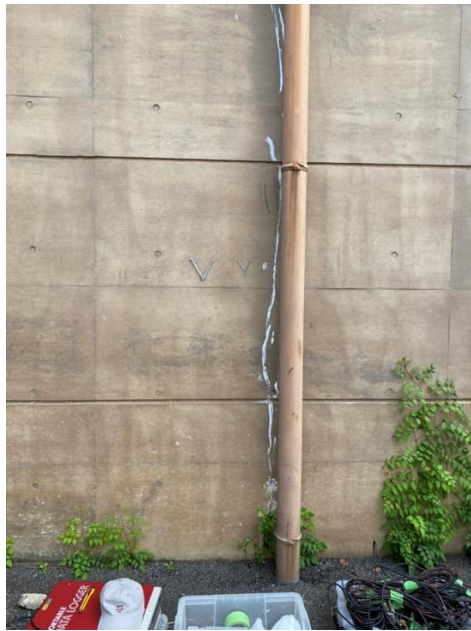
中央ひび割れ（屋外側）
