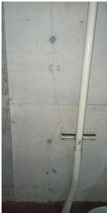
中央ひび割れ（屋内側）
