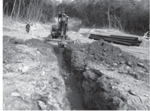
21-2 調査区北部～中央部1号水路・暗渠排水管掘り方南部掘削状況（南より）
