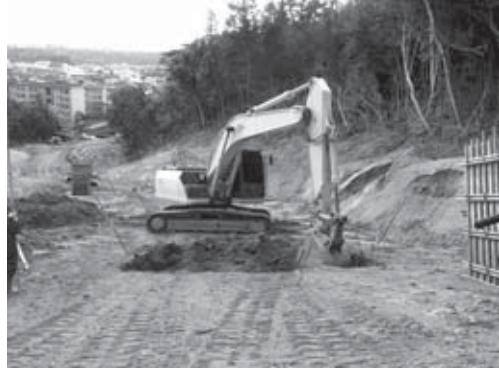
19-2 調査区中央部 7 区 (暗渠排水管支柱基礎) 掘削状況 (北西より)
