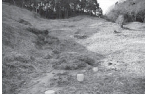
22-2 災害による崩落の状況（南より）
