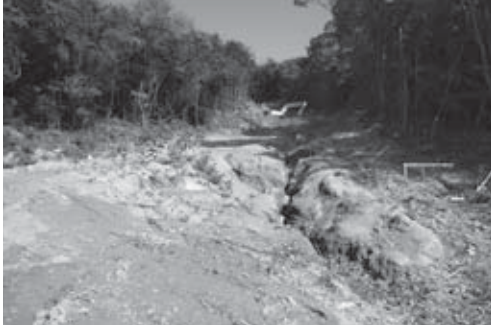
10-1 災害状況全景（南より）
