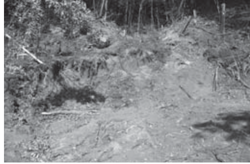
10-2 災害箇所北端崩落状況（南より）
