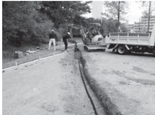
24-4 電気配管路掘り方未舗装部堆積状況（南東より）
