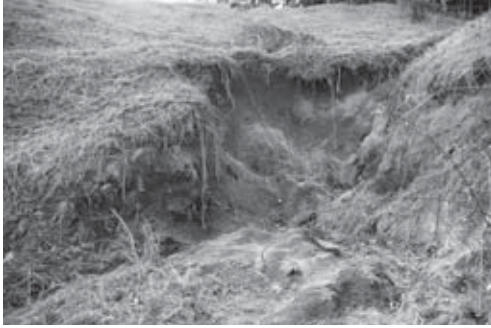
22-1 災害による崩落の状況（北東より）
