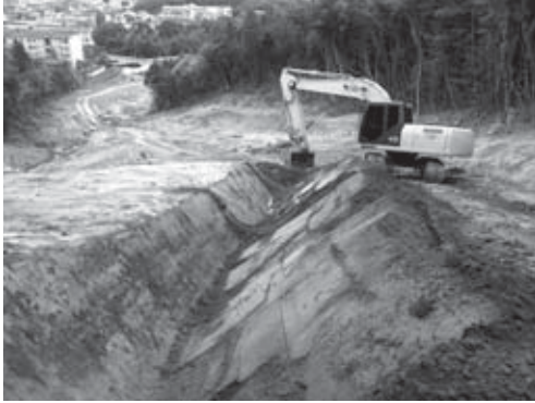
16-1 調査区北部 (No.27-26 付近) 中央部水路 東側法面掘削状況 (北より)
