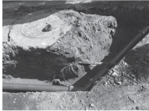
31-2 2区北部柵部分周辺配管状況（西より）
