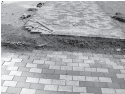
24-3 電気配管路掘り方通路部堆積状況（南西より）
