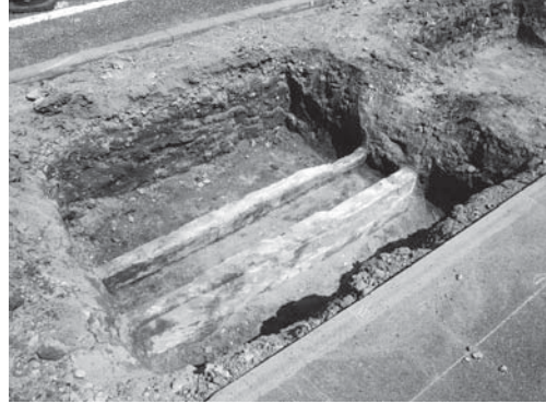
11-2 駐輪場E・9区コンクリート排水路検出状況(南東より)
