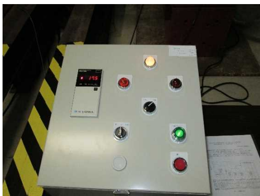
写真 3.12 自動荷重操作盤
