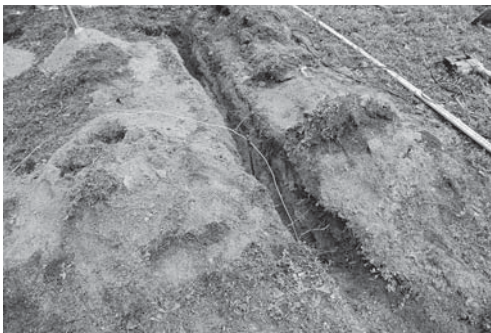
9-3 No.5 アース掘り方および周辺部配線掘り方完掘状況（北西より）
