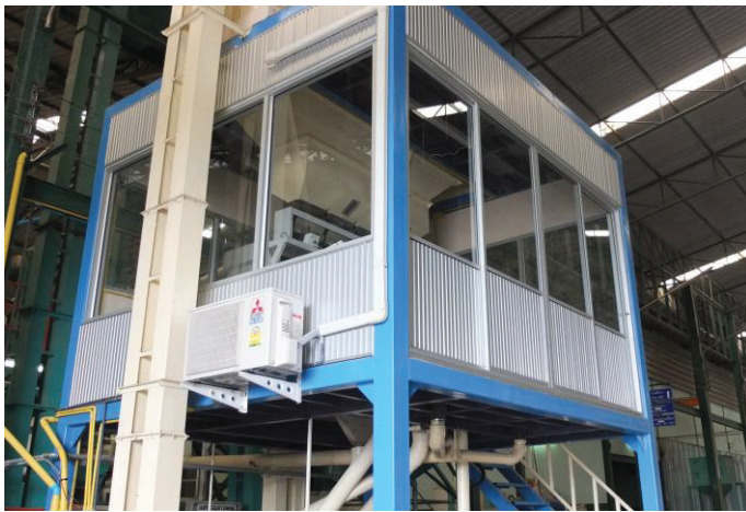
写真 3-4 光選別機専用のクリーンルーム
