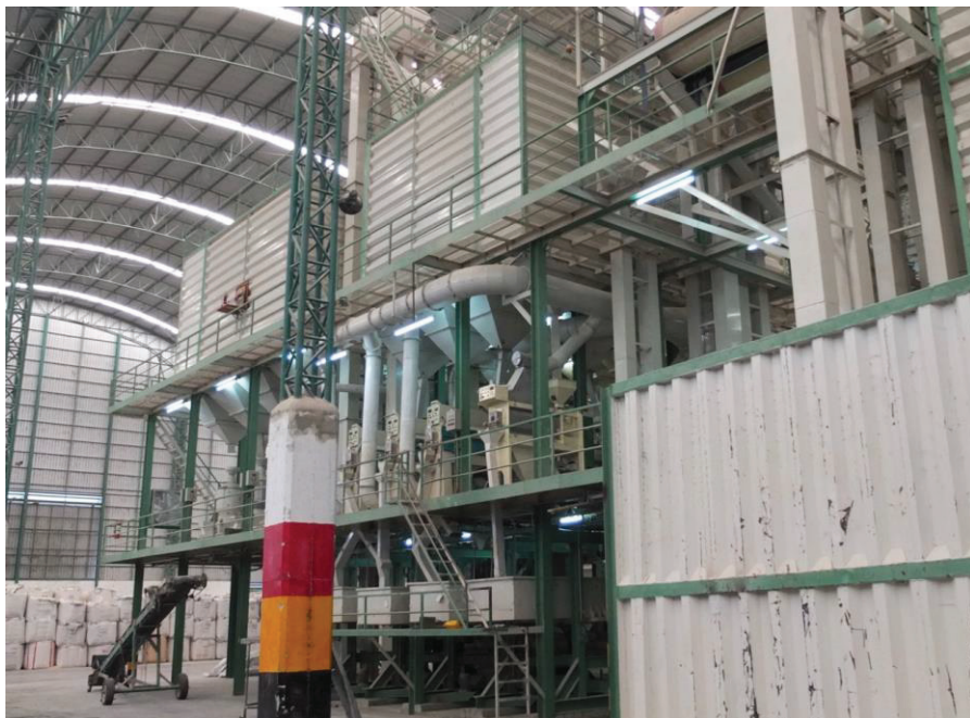
写真 4-7 架台に据え付けられた精米設備
