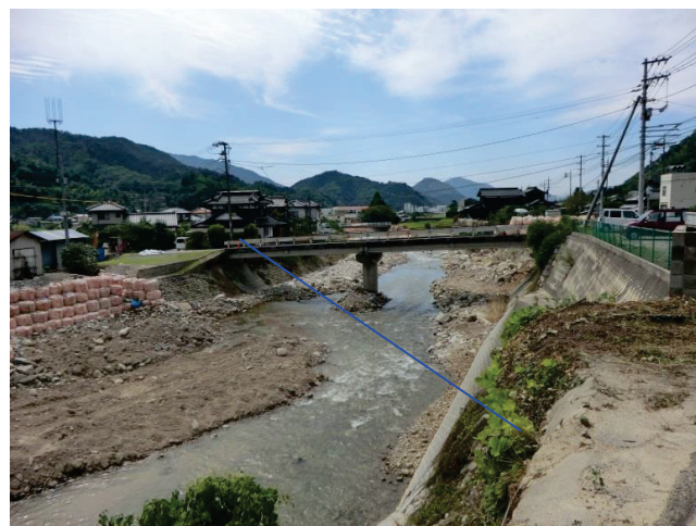
写真-1.2 根谷川における護岸破壊状況
