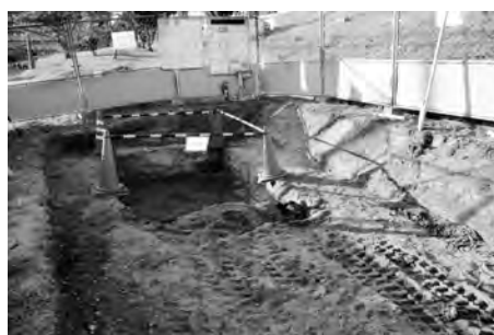
写真2 KDDI 携帯電話電波塔設置工事 機械設置場所掘削状況（東より）
