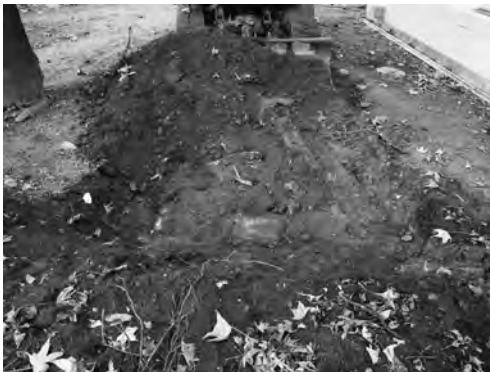
写真 79 ロータリー北通路屋根取設その他工事 9区完掘状況 (東より)
