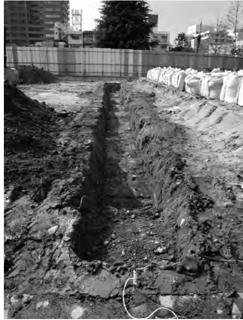
写真 95 知的人材育成センター新営工事 13 区 コンクリート面検出状況（東より）
