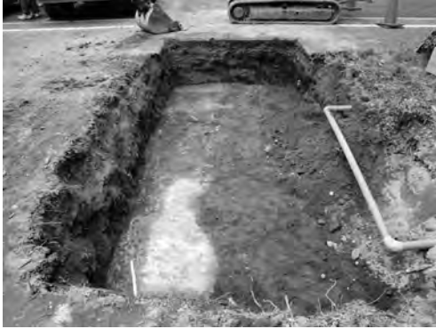
写真 6 霞会館北側渡り廊下設置工事 2 区コンクリート床面検出状況（東より）
