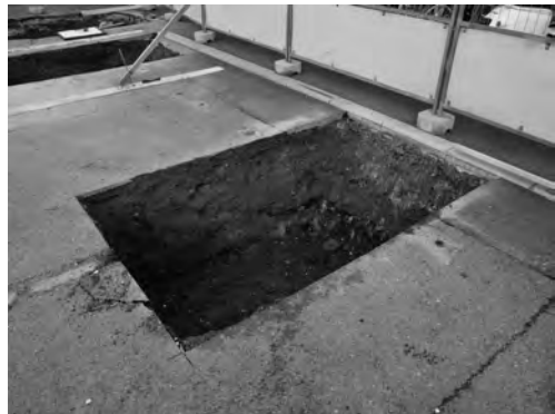
写真 62 ロータリー北通路屋根取設その他工事 3区完掘状況(東より)
