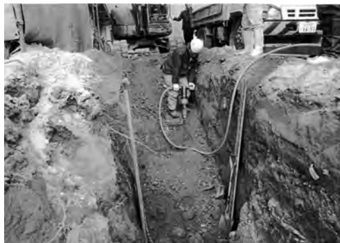
写真 54 医療支援センター・総合研究棟ほか外構工事 7-6区煉瓦・コンクリート基礎撤去状況（南より）
