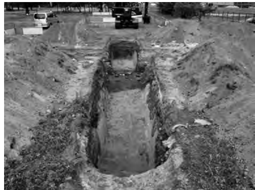
写真 86 知的人材育成センター新営工事 1 区 1 区拡張区完掘状況 (東より)
