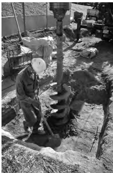
写真3 KDDI 携帯電話電波塔設置工事 アンテナ支柱基礎掘削状況（西より）
