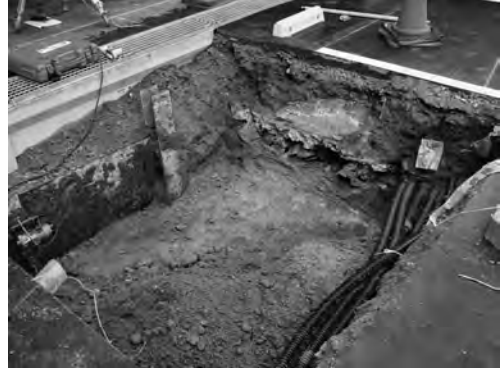
写真 29 震地区北西部渡り廊下設置工事Ⅱ区 西区完掘状況（南東より）
