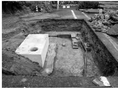
写真 19 震地区北西部渡り廊下設置工事Ⅱ区 東区コンクリート床、コンクリート基礎、 煉瓦積遺構検出状況（北より）
