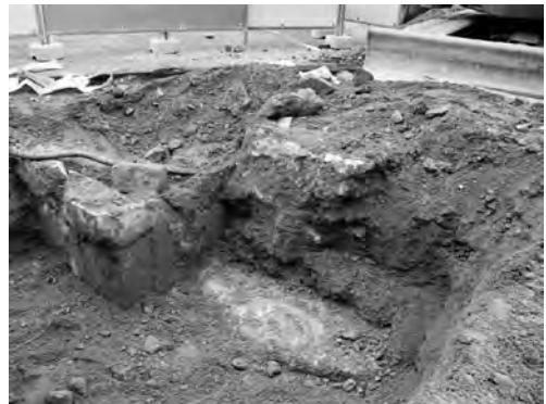
写真 78 ロータリー北通路屋根取設その他工事 29区コンクリート柵およびコンクリート 構築物検出状況 (南東より)
