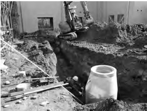
写真 52 医療支援センター・総合研究棟ほか外構 工事 7-5区完掘状況(西より)
