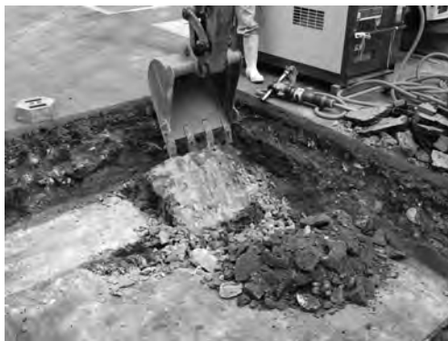
写真 26 震地区北西部渡り廊下設置工事Ⅱ区 中央区コンクリート床ほか撤去状況（東 より）
