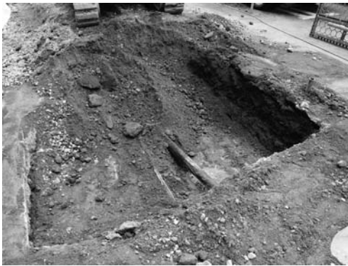
写真 90 キャンピー設置工事地区北部キャンピー基礎掘り方掘削状況（南より）
