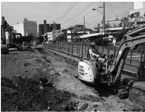
写真 101 擁壁設置工事地区擁壁掘り方北部・中央部掘削状況（北より）
