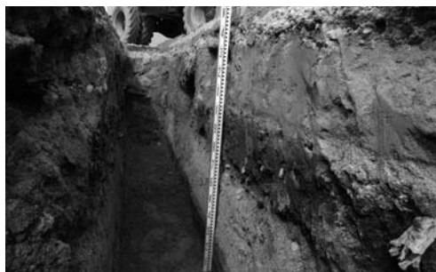
写真 57 エネルギーセンター増設工事に伴う電気 工事南北掘り方（南より）
