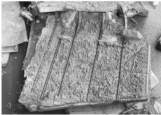
(a) リラス結束線腐食 (中越地震)
