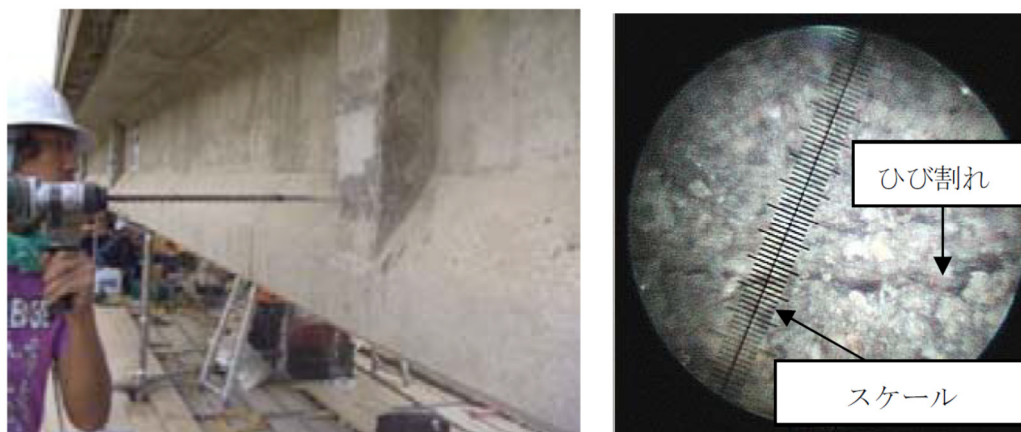
図2.7 内視鏡による測定の様子（左）とひび割れ幅の計測状況（右） 2.7)
