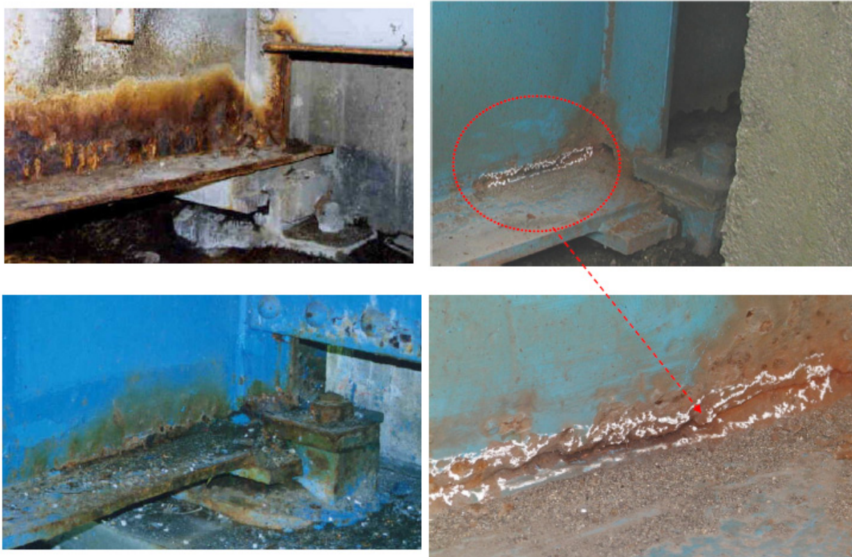
図-2.9 桁端部の腐食損傷事例 2.41)
