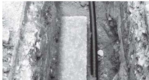
写真 68 A 地区 2・3 区間電気配管掘り方石 製構造物西端部 (東より)
