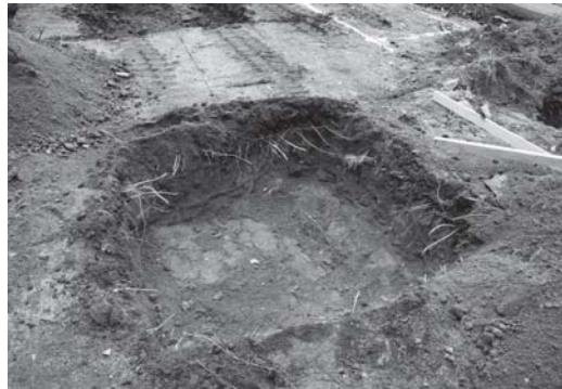
写真 146 中学校駐輪場取設工事東側駐輪場支柱基礎東端完掘状況(南より)
