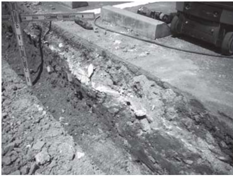
写真76 C地区1区東側電気配管路掘り方内堆積状況（東南より）
