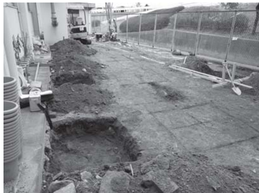
写真 147 中学校駐輪場取設工事西側駐輪場支柱基礎西列完掘状況(南より)
