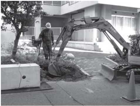
写真 89 外灯新設・改修工事（第Ⅱ期）E地区（薬学部研究棟南西隅）全景（南より）
