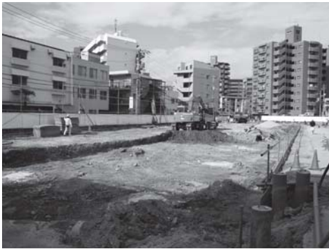
写真 11 レジデントハウス・ゲストハウス新 営工事地区全景（東より）
