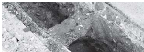
写真 67 A 地区 2・3 区間電気配管掘り方木 製構造物検出状況 (北西より)
