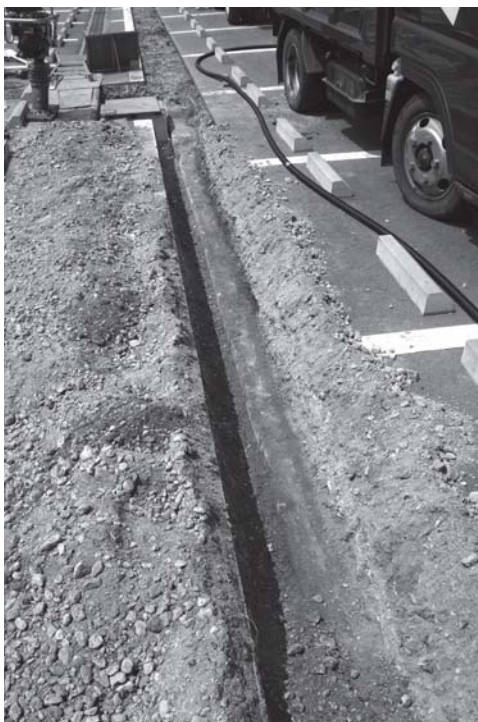
写真 86 D地区1区東側電気配管路掘り方 コンクリート面検出状況（東より）
