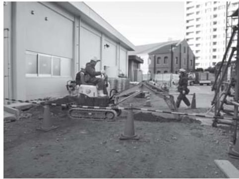
写真135 北ボイラー棟生活配水管ほか布設工事掘削状況(東より)
