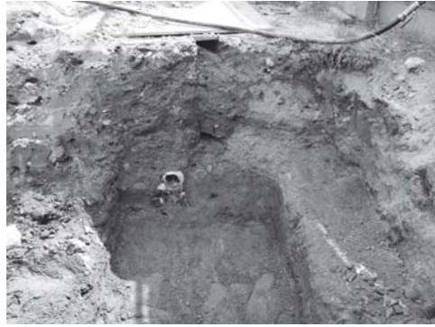
写真 25 電気配管布設地区ハンドホール基礎掘り方完掘状況（西より）
