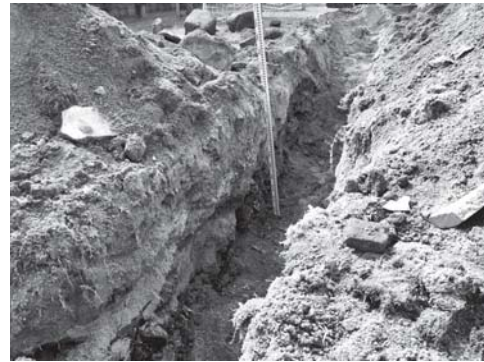
写真 61 プール南側排水管新設工事 No.3・No.4 桝間掘り方（北部）堆積状況
