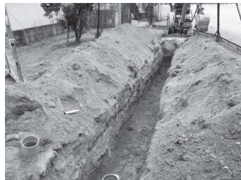
写真 59 プール南側排水管新設工事 No.4・No.2 桝間管掘り方（中部～南部）堆積状況
