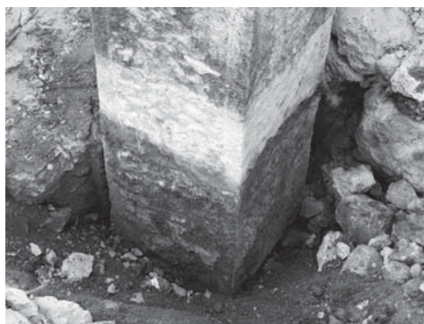
写真51 門柱基礎露出状況
