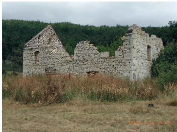
写真44 グルーボルスキー・ナースロンの草むらの中に放置された破壊された住宅
