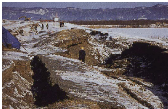
写真 2.8 十勝川統内築堤の被災状況 10)
