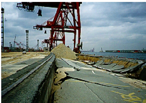
写真 2.12 ポートアイランドにおける岸壁の液状化による側方流動状況 14)
