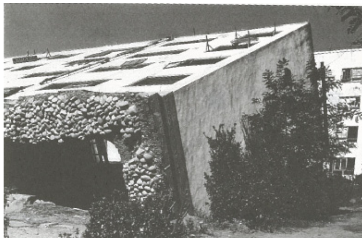
写真 2.1 県営川岸町アパートの転倒 1)
