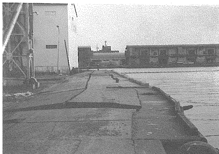
写真 2.7 釧路港北埠頭③南岸壁 (-8.0m) 被災状況 9)
