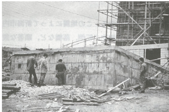
写真 2.3 地下浄化槽の浮上 1)
