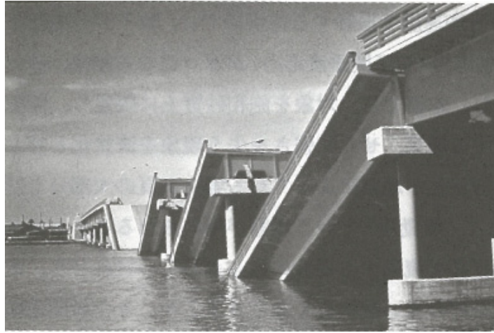
写真 2.2 昭和大橋の落橋 1)
