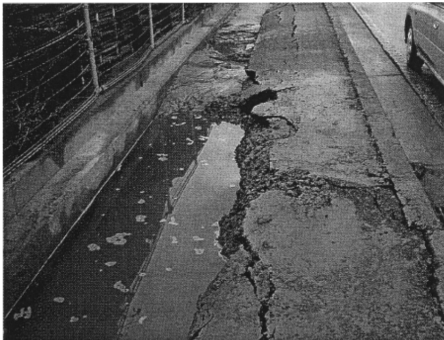
写真 2.14 境港市昭和町の道路側溝からの噴砂状況 18)
