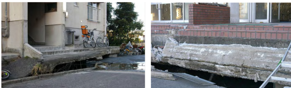
写真 3.1 浦安市で発生した抜け上がり被害の例 12)
