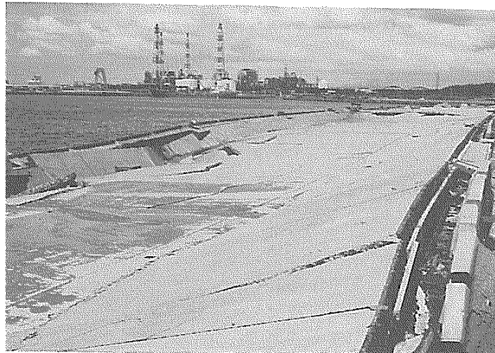
写真 2.5 大浜-10m 2号岸壁のエプロン沈下状況 8)
