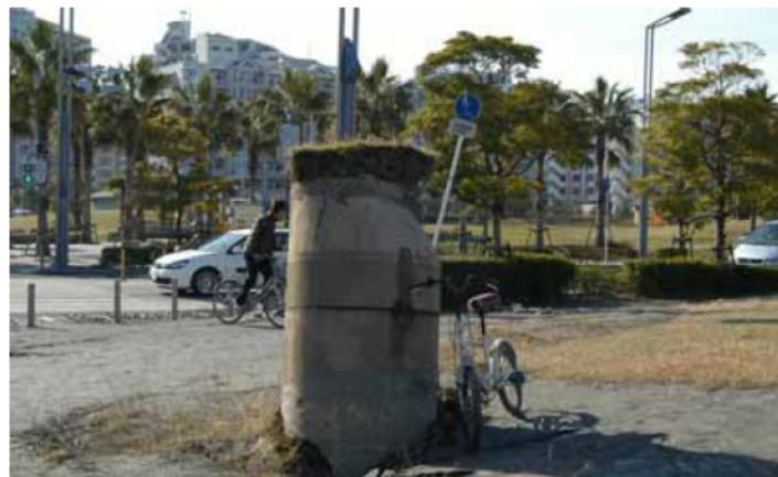
写真 2.17 千葉県浦安市明海地区のマンホールの浮き上がり状況 21)
