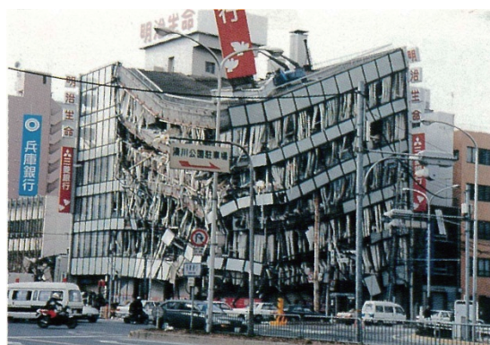
捩れ振動による崩壊（1995・神戸）
