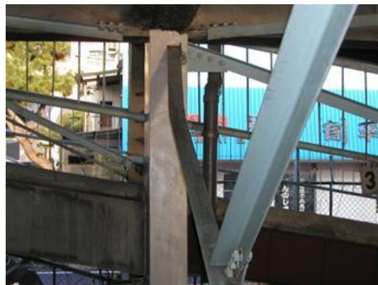
写真3.2.2 芸予地震により座屈した筋かい軸部
