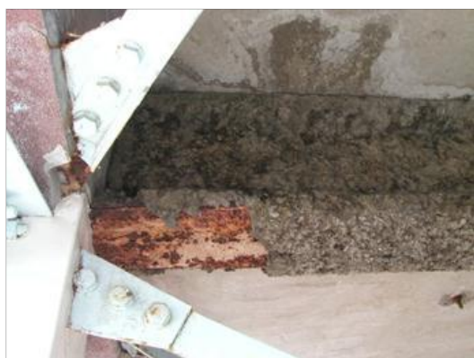
写真 3. 2. 3 鉄骨大梁の腐食状況
