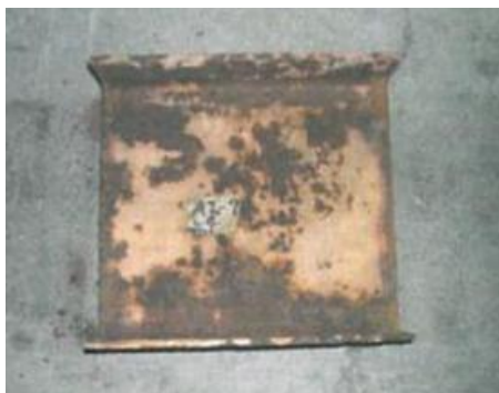
写真3.2.7 錆・塗装の除去前の状態
