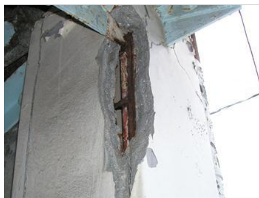
写真 3. 2. 4 鉄骨柱の腐食状況
