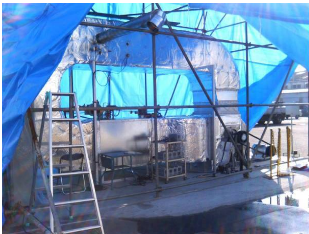
図 3.4 加熱試験設備の外観
