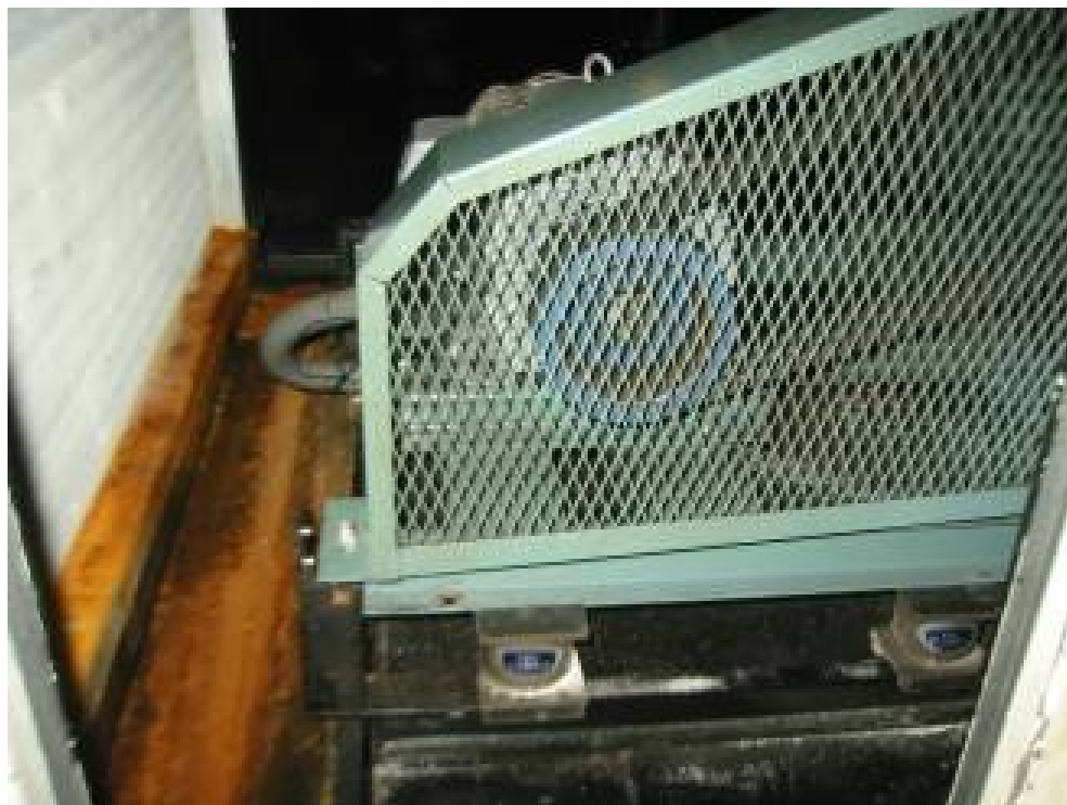
図 4.1 冷温水コイルチャンバー内に設置された遠心ファンのモータ周辺
