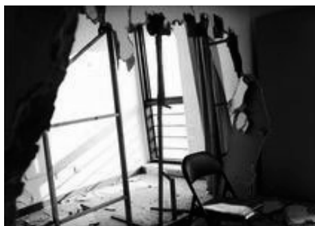
写真7 上海群租取締りの現場（破られた壁）
