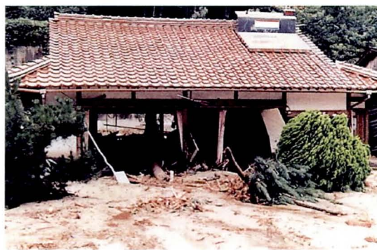
写真-4.2 江河内谷川の土石流（殿賀駅より） 2) Photo 4.2 Debris flow in Egouch district in Kake town
