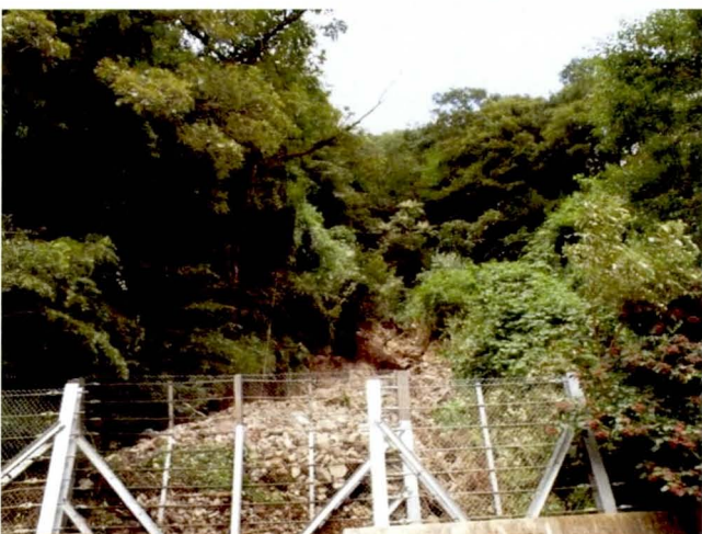
写真-4.8 中古生層の粘板岩分布域で発生した崩壊 Photo 4.8 Slope failure in a Paleozoic-slate-area 斜面を流下し，道路際に設置された落石防止柵で石礫堆を形成して停止している。 （広島県安芸太田町地区， 位置は図-4.4 の E 位置付近）
