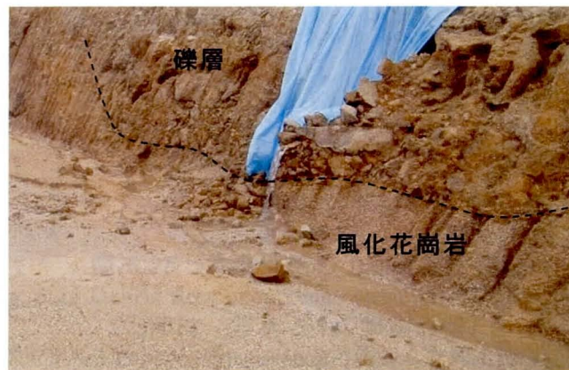
写真-5.4 礫層の基底付近からの湧水事例
