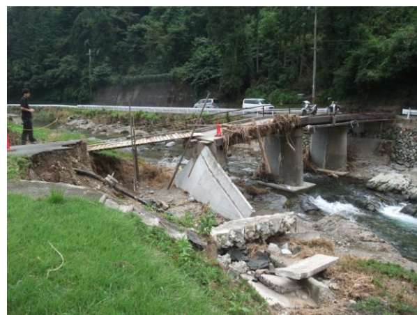
写真-1 H21.8.9 兵庫県佐用郡の集中豪雨の被災構造物 1)
