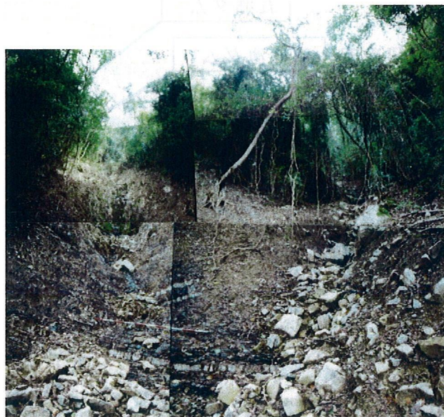
写真 5-7 大野原町の土石流源頭部崩壊地の直下部 溪床にはいぜんとして部分的だが岩盤の露出が見られる。礫質土壌である。崩壊地勾配は 34°、広葉樹を主とした自然林地帯での崩壊である。
