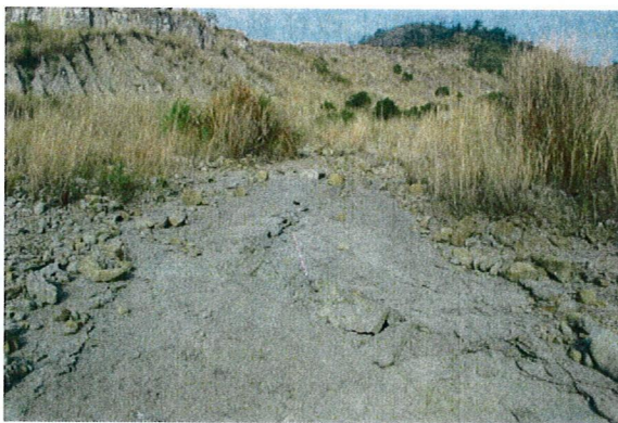
写真 5-14 草嶺の大規模崩壊面に見られる新たな圧縮亀裂(2004年12月29日撮影)
