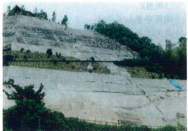
写真 1-8 マサ土斜面のモルタルに発生した変状
