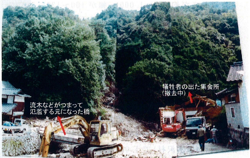
写真 5-3 台風15号豪雨の土石流と濁流で犠牲者の出た香川県大野原町の現場
