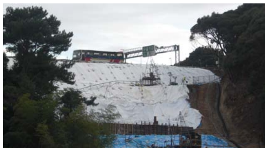
写真-1 東名高速道路牧之原SA付近の盛土法面の崩落地点 (応急復旧後の2009年9月19日撮影)
