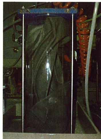
写真-8.2.1 空圧・水圧変換タンク
