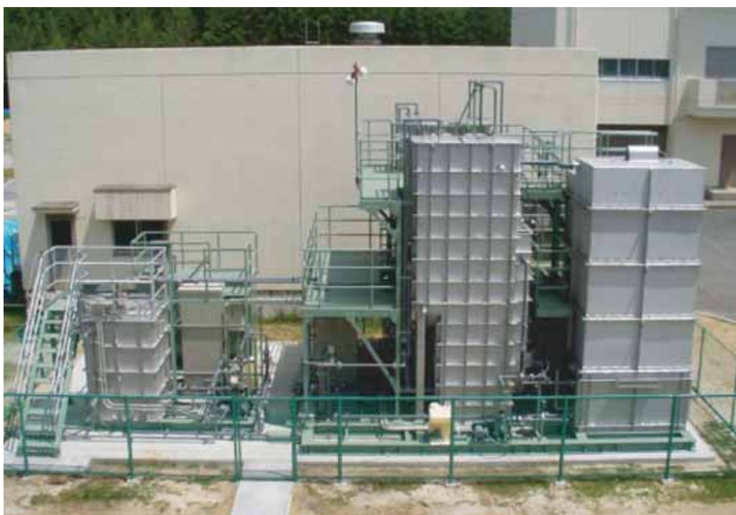
写真 4・1 パイロットプラントの全景 (左から原水槽, 嫌気槽, 好気槽)
