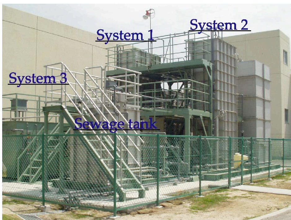
写真 4-1 パイロットプラントの全景
